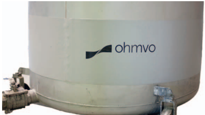
Sistemi riscaldanti Ohmvo posizionati su tanica.
